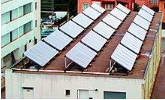
Mallorca'daki bir otelde içi sıcak su hazırlaması için güneş kolektörleri.Yuzum
