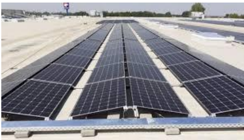
Plantas de energía fotovoltaica en el nuevo centro logístico y en las tiendas Dedeman de Bacău, Rumanía
