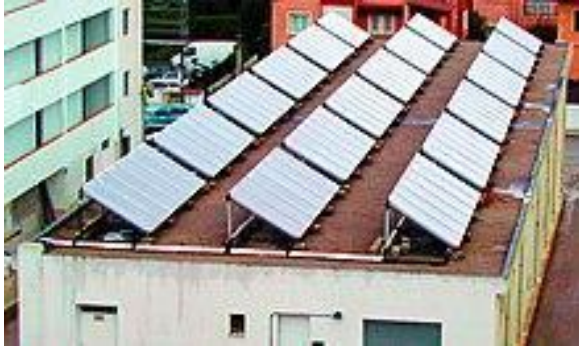
Colectores solares para la preparación de agua caliente sanitaria en un hotel de Mallorca.
