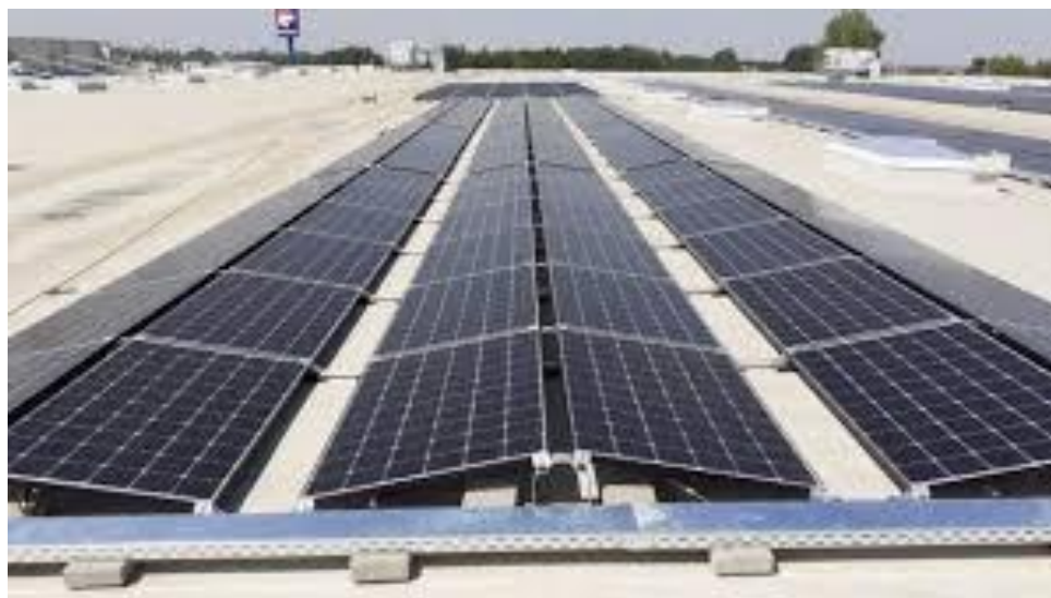
Centrale fotovoltaice la noul centru logistic și la magazinele Dedeman din Bacău, România
