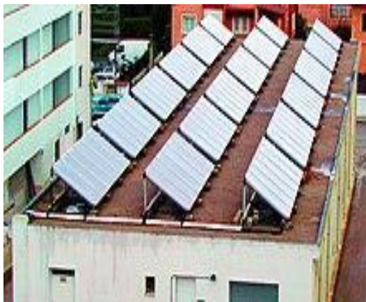
Collettori solari per la produzione di acqua calda sanitaria in un hotel a Maiorca.
