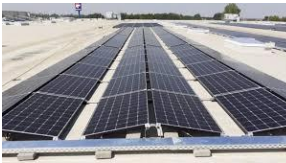
Impianti fotovoltaici presso il nuovo centro logistico e i negozi Dedeman a Bacău, in Romania
