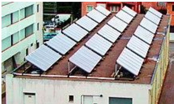
Solarni kolektori za pripremu tople vode u hotelu na Mallorci.
